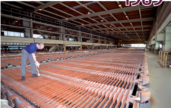
Inbetriebnahme der Elektrolyse Werk Ost (ELWO)
